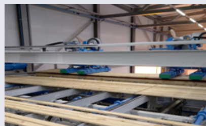
Overzetstation. Hier worden de planken per laag de productielijn ingebracht
