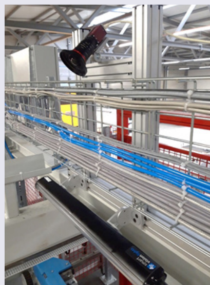
Installatie van Vision camera met belichting
